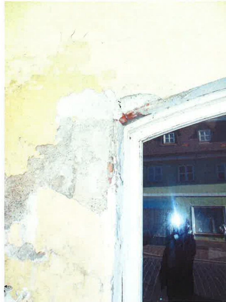
Abbildung 3 Der Putz ist an mehreren Stellen der Fassade abgeplatzt
