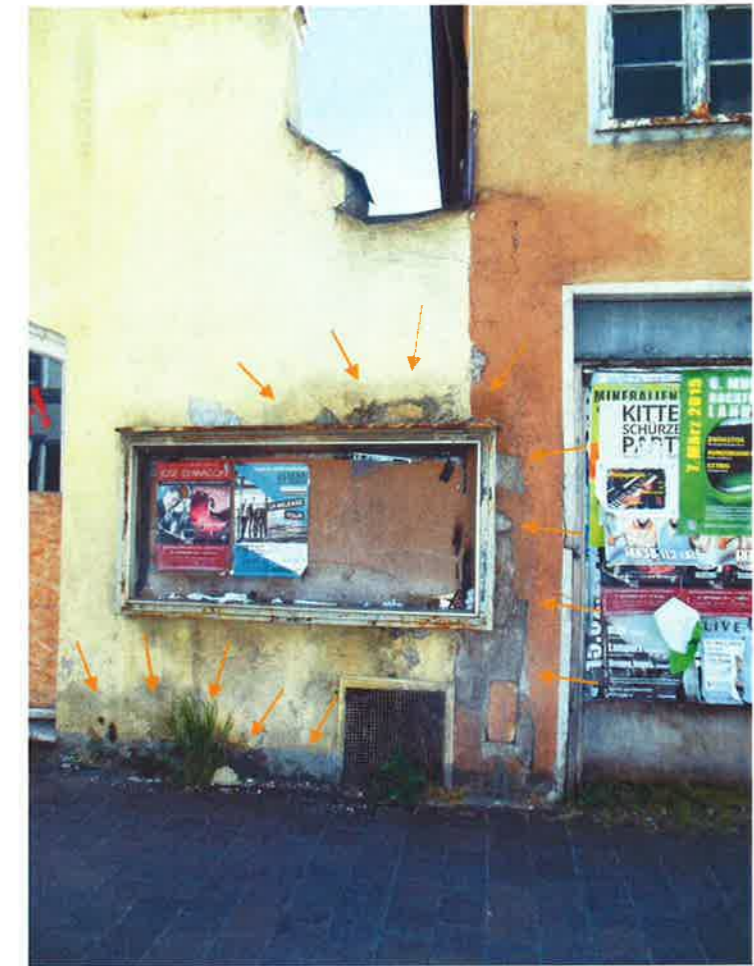
Abbildung 4 Vor allem im Sockelbereich, aber auch an einigen anderen Stellen der nördlichen Fassade sind Feuchtespuren und Algenbildung ersichtlich. Das Mauerwerk ist stark durchfeuchtet.
