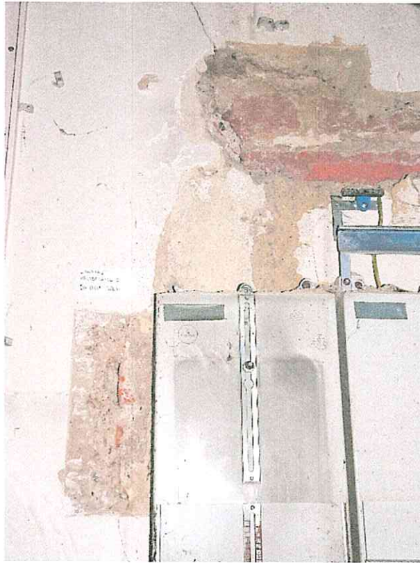
(15) Erdgeschoss, Raum 0.01, Westwand: rechte Leibung und Kämpfer einer ehemaligen Tür zum Raum 0.12 im bauzeitlichen Mauerwerk (vor 1665 (d)), 1934 (a) zugesetzt.
