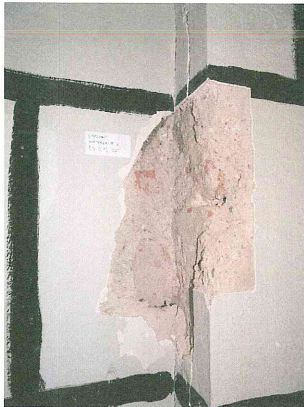
(26) Erdgeschoss, Raum 0.12, Ostwand: Vorsprung in der bauzeitlichen Wand zum Fletz (vor 1665 (d)), möglicherweise an der Stelle eines alten Wandanschlusses. Alle historischen Putze wurden abgeschlagen und die Wand 1934 (a) neu verputzt.
