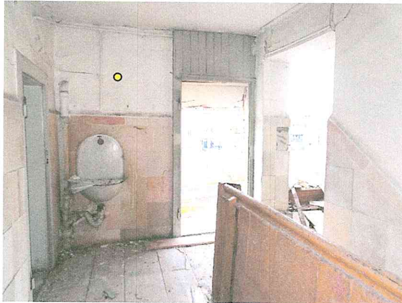
(29) 1. Dachgeschoss, Raum 1.01 nach Süden: zwischen den Resten des bauzeitlichen Giebels befinden sich einige Durchbrüche und Zusetzungen beim Anschluss des ehemaligen südlichen Anbaus. Das Mauerstück links der Tür ist eine Zusetzung der Zeit um 1900 (gelber Punkt).
