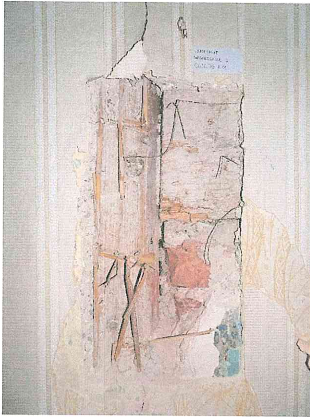
(43) 1. Dachgeschoss , Raum 1.11, Südwand: Fachwerk des Dachgeschossausbaus von 1866 (d), mit in der ersten Hälfte des 20. Jahrhunderts ausgetauschter Ausfächung (violetter Punkt). Bei der Neuverputzung dieses Abschnittes wurden die Rohrmatten mit modernen Häkchen statt der geschmiedeten Nägel befestigt.
