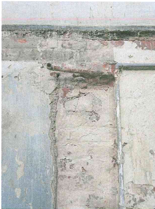
(06) Ausschnitt Südfassade: bei dem ehemaligen Wandanschluss des südlichen Anbaus ist nun das bauzeitliche Mauerwerk mit verstrichenem Fugenmörtel und einer Kalkschlämme zu sehen, das sich bis hinauf zur Höhe der Kehlbalcken fortsetzt (vor 1665 (d), vermutlich spätmittelalterlich). Darüber und an den Ortgängen ist das Mauerwerk jünger.
