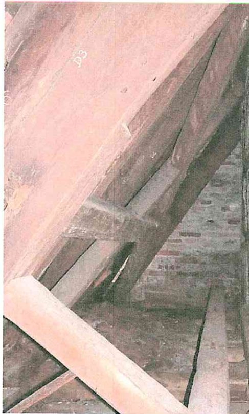
(40) 1. Dachgeschoss, westliche Abseite Dachwerk mit liegendem Stuhl und An zur Längsaussteifung (1665 (d)). Die Fa rechts gehört zum Dachgeschossausbau Im Hintergrund der bauzeitliche Nordgieb
