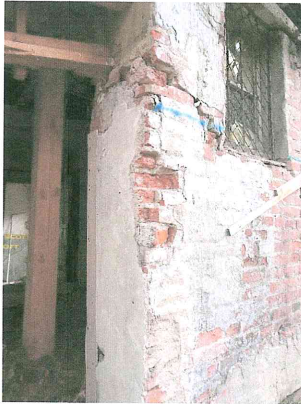
(03) Detail Westfassade: der Durchgang in das Nachbarhaus Nr. 4 wurde nachträglich in das bauzeitliche Mauerwerk (vor 1665 (d)) gebrochen, die Ziegel weisen abgeschlagene Oberflächen auf. Der Fensterstock rechts oben wurde wohl 1934 (a) eingebaut.
