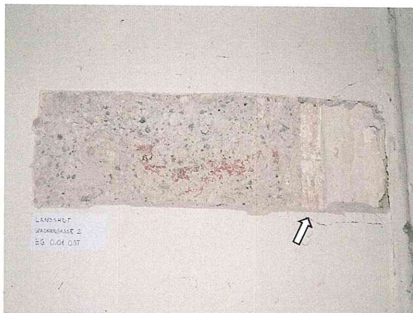
(12) Erdgeschoss, Raum 0.01, Ostwand: in den Eingabeplänen von 1906 und 1934 ist an dieser Stelle, dem Übergang vom bauzeitlichen zum barocken Mauerwerk, ein rechtwinkliger Absatz zu sehen, der Mitte des 20. Jahrhunderts abgeschlagen und neu verputzt worden ist (links). Rechts des ehemaligen Absatzes sind die älteren Putze und Fassungen noch vorhanden (Pfeil)..
