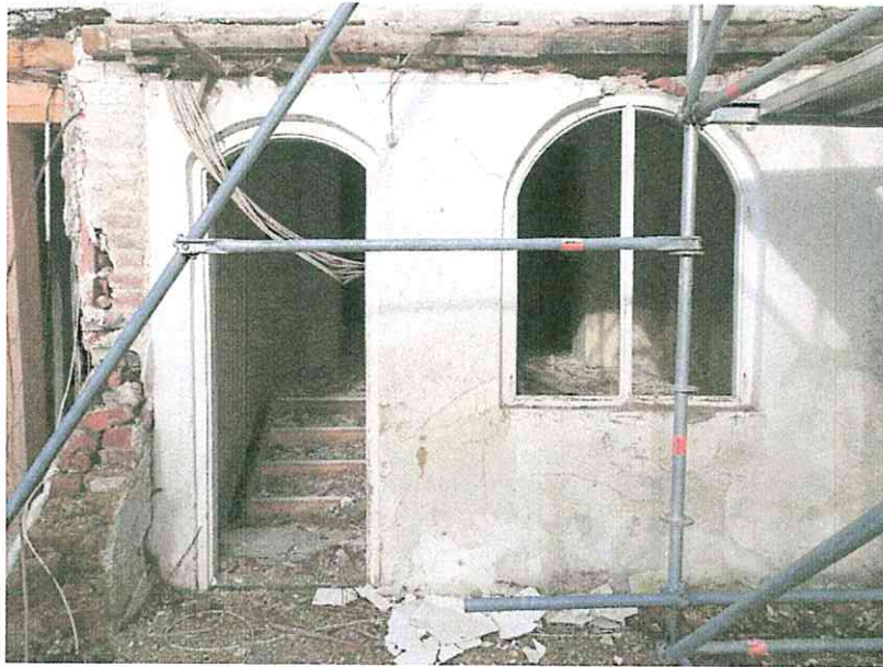
(07) Ausschnitt Südfassade: die Südwand des Raumes 0.03 wurde um 1900 in eine große Öffnung zum südlichen Anbau gesetzt, aus dieser Zeit stammen auch der Tür- und der Fensterstock.
