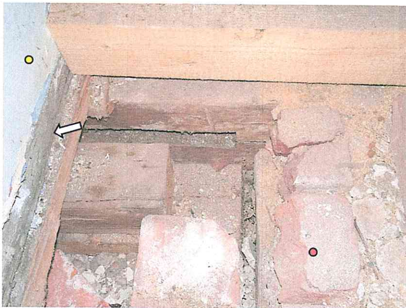
(32) 1. Dachgeschoss, Raum 1.02, Bodenöffnung: der Zerrbalken mit der Nut gehört zum Dachwerk von 1665 (d). In der Nut saß damals die Bretter-Leisten-Decke über dem Raum 0.12, die hier an der Wand zum Fletz 0.01 endete. Über dieser bauzeitlichen Wand wurde die Mauerkrone 1665 auf das heutige Niveau erhöht (roter Punkt). Die Wand des Dachgeschossausbaus von 1866 (d. gelber Punkt) sitzt auf einem zweitverwendeten unterseitig profilierten Balkenstück von 1665 (Pfeil).
