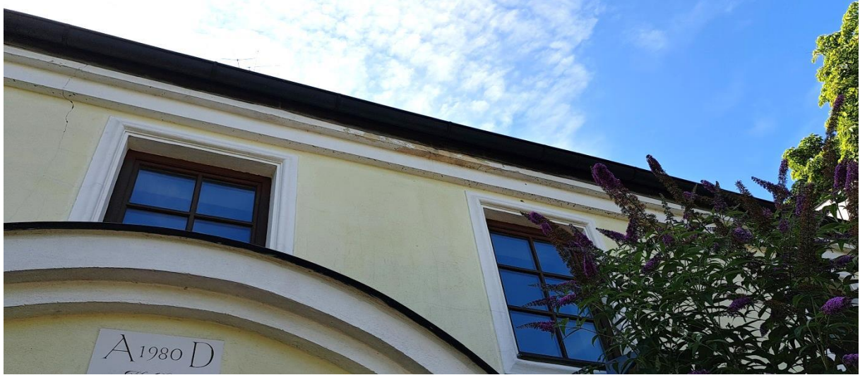
Abb. 4 Bereich des nachgewiesenen Nistmaterials zwischen dem Dachsim und der Dachrinne an der Nordfassade des Gebäudes
