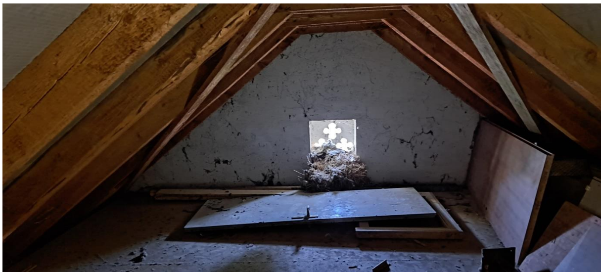
Abb. 1 Altes Vogelnest im Bereich der offenen Lüftungslöcher an der Südwest-exponierten Firstseite
