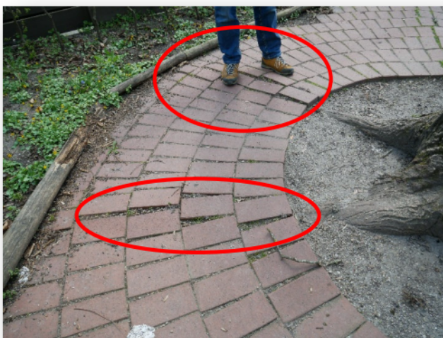
Abb. 5 Angehobenes Pflaster im Wurzelbereich
